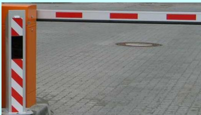
CAR-READER Videosäule an einer Schranke installiert
