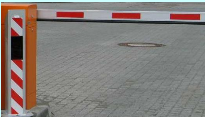
CAR-READER Videosäule an einer Schranke installiert
